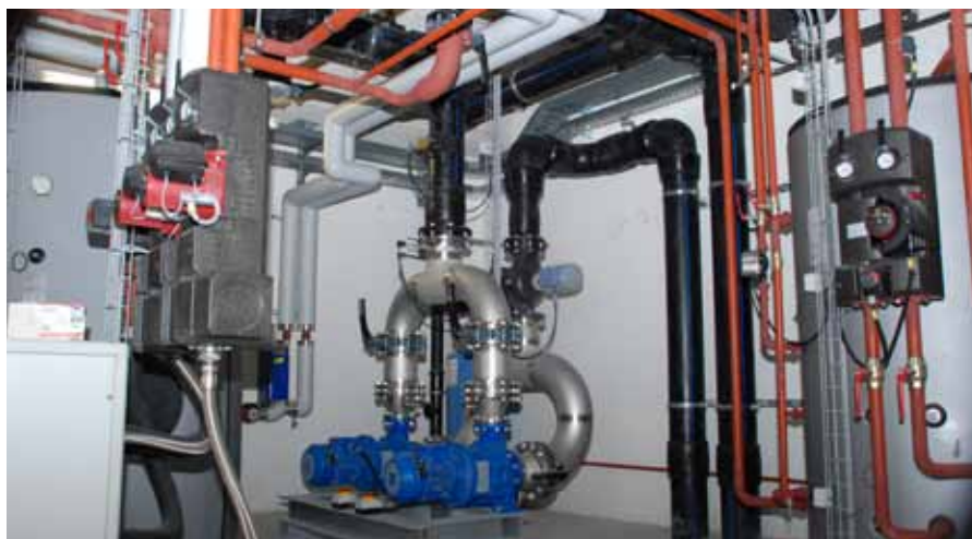
Kontrollraum mit isolierten Rohrleitungen und Kältepumpen: Diese werden über Vacon 100 HVAC Frequenzumrichter gesteuert.
