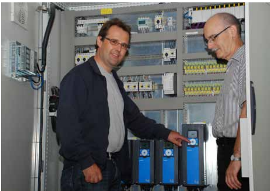
Sepp Hersche, Projektleiter bei FRIGEL und Peter Hänsele, ELEKTRON mitten im Schaltschrank.
