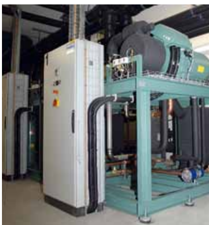
Eine von drei Kältemaschinen
